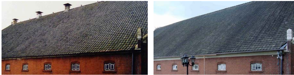
Figuur 4.12: Verwijderde ventilatie-units en gewijzigde gootdetails Bron: gemeente Borger-Odoorn (2003) en Vieveen (2011b)
