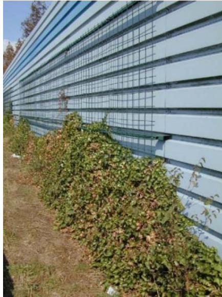
Figuur 23: Metalen geluidsscherm, platen en klimhulp beide ongeschikt voor klimop. (Bron: PPO)
