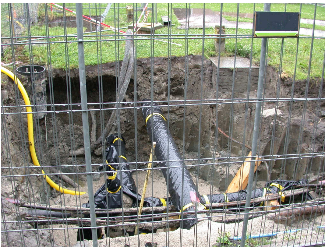
Figuur 12: Grond rondom kabels en leidingen is weggezogen, om zo graafschade te voorkomen. Foto: Harry Oosterhoff
