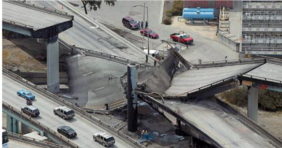
Figuur 6.4: ingestorte sectie hoge snelweg in San Francisco, april 2007, nadat een tankwagen tegen de pijler is gebotst en in brand is gevlogen (bron: www.dailymail.co.uk )
