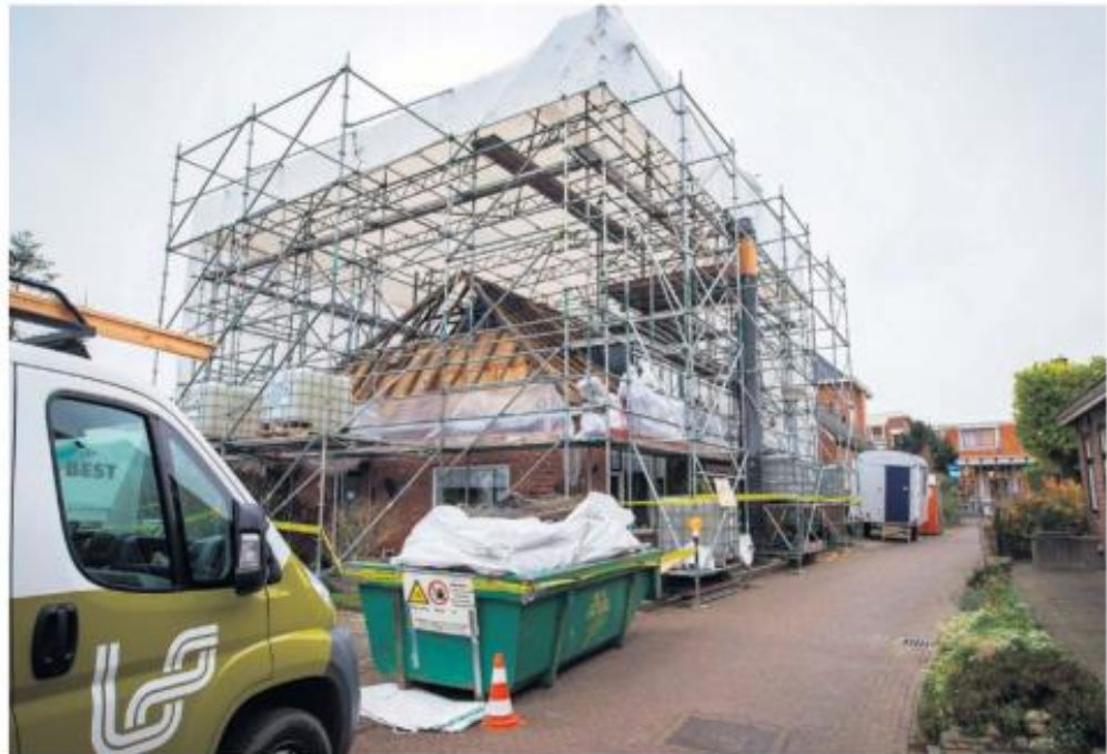
Herstelwerk in Loppersum. FOTO OWIK
